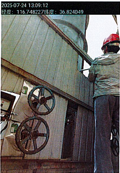
2#燃气轮机组排气筒 (DA002)
