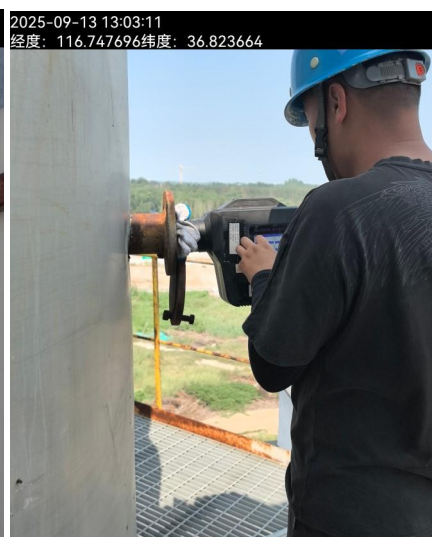
4#燃气轮机组排气筒 (DA019)
