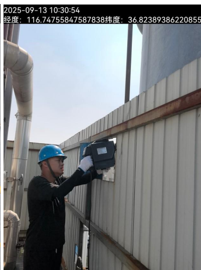
3#燃气轮机组排气筒 (DA018)
