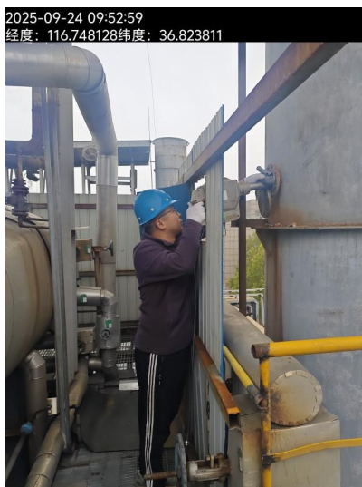
2#燃气轮机组排气筒 (DA002)
